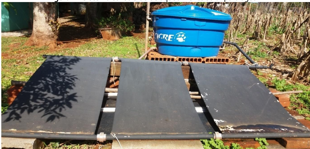
Figura 6 - Sistema construído de aquecimento solar para água
