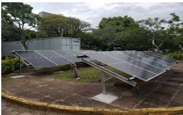
Figura 5 - Instalação fotovoltaica de solo
