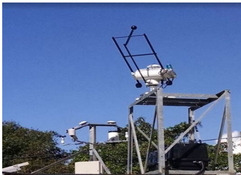
Figura 7 - Sistema de rastreamento solar: piranômetro e pireliômetros a ser instalado
